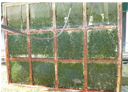
Рис. 1. Забруднення водяних сіток СТВ водоростями (АЕС Моховце)
